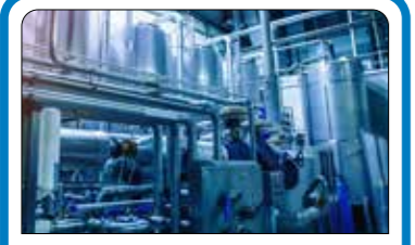
Spolvattnet renas från kvicksilver genom kemisk fällning till dess att vattnet uppnår nationella lagkrav.
